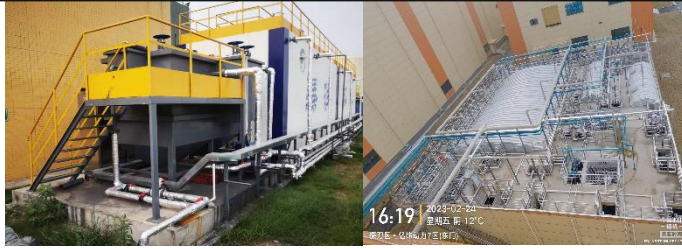
湖北亿纬废水处理站 惠州亿纬废水处理站
